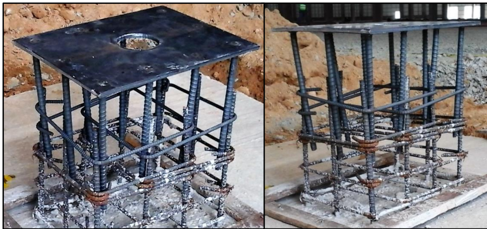
Ilustración 23: Choque de varillas de anclaje con el armado del dado
