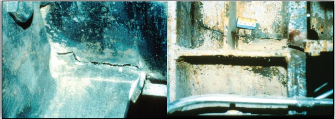
Ilustración 70: Fallas de soldadura durante sismo
