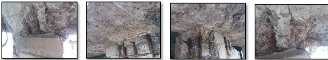
Fotografía 1-9 Desprendimiento del hormigón
