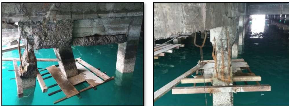
Fotografía 1-11 Pilote sin estribos
