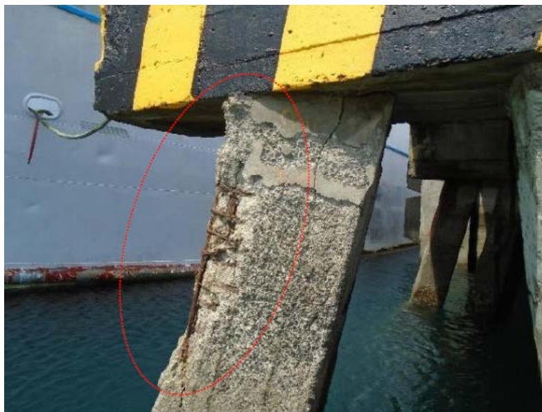
Nivel de daño severo
