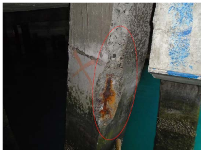
Nivel de daño moderado
