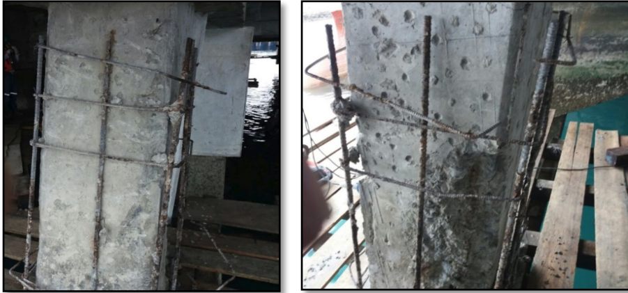
Fotografía 1-12 Pilotes con estribos de mayor espaciamiento
