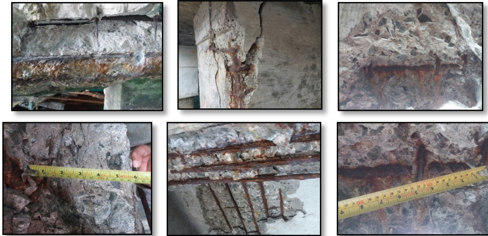
Fotografía 1-8 Corrosión del acero de refuerzo
